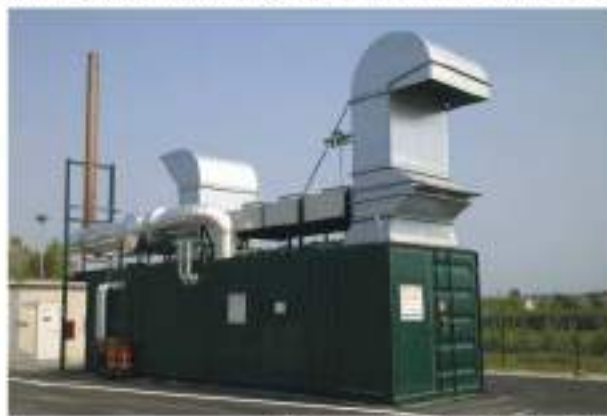
Modulo cogenerativo di un impianto a biogas
