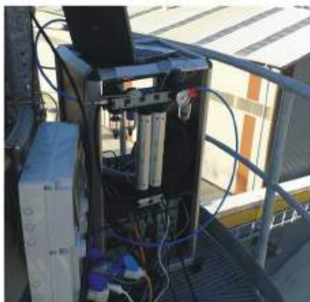
Strumentazione posizionata su un camino
