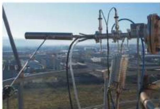
Linea di campionamento su camino impianto a combustione di biomassa solida
