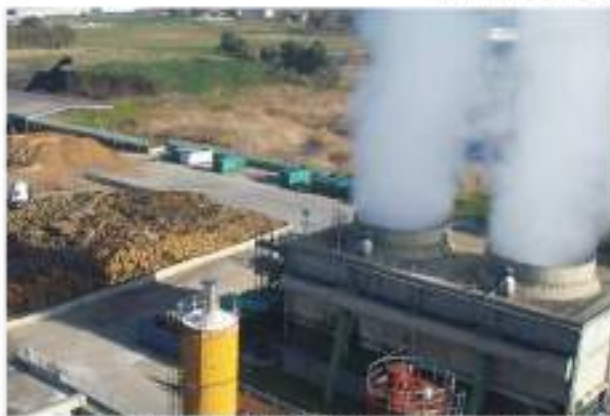
Deposito legname e torri di raffreddamento di impianto a biomasse
